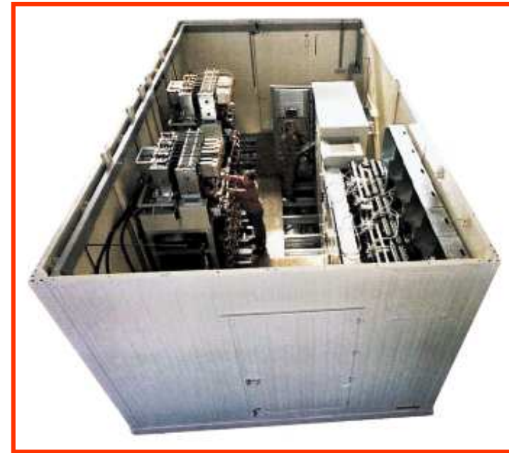
Restaurador dinámico de tensión (DVR) de 4 MVA
