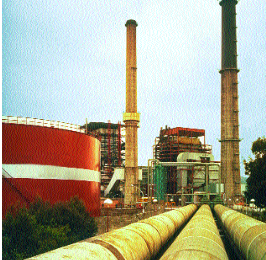
Conducciones y tanques de almacenamiento de la central térmica de Algeciras
