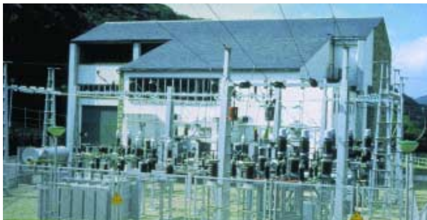
Subestación de transformación en la central hidroeléctrica de Prada
