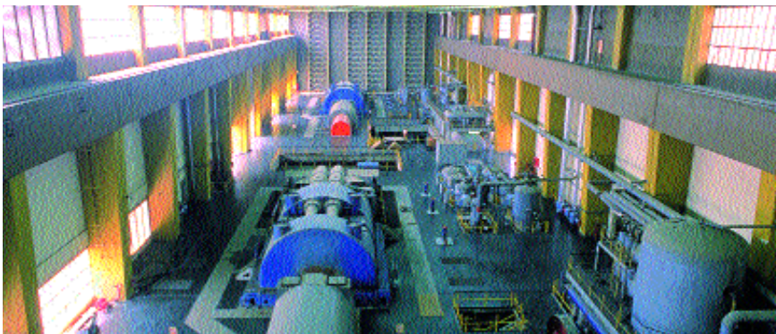
Grupos generadores de la central térmica de San Adrián
