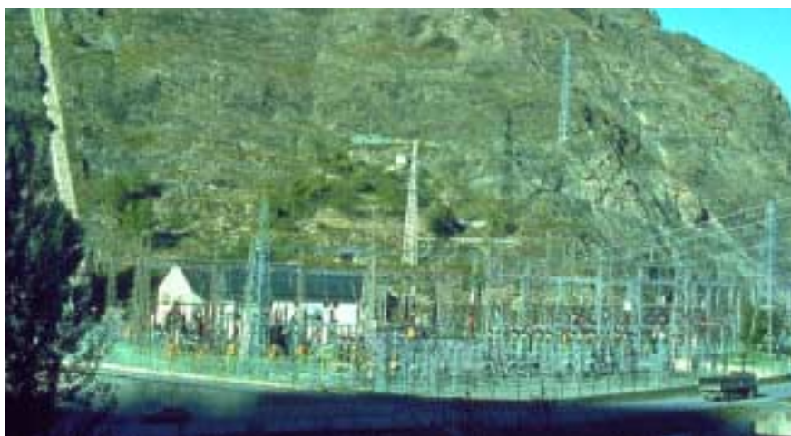
Subestación transformadora de la central hidroeléctrica Llavorsi Cardós
