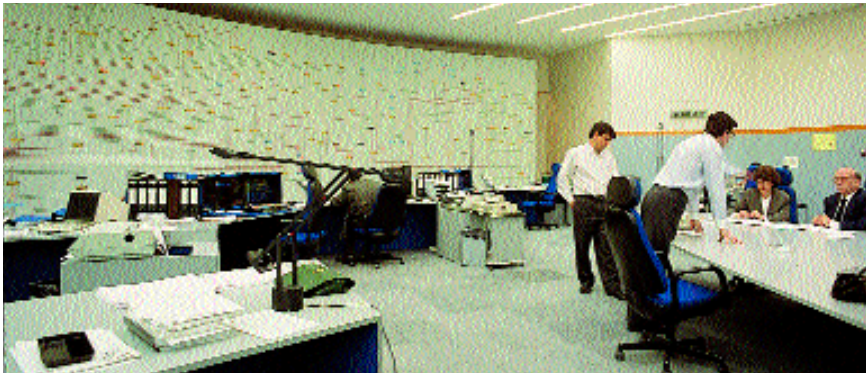
El control y la gestión de la electricidad se realiza desde centros dotados con los medios precisos
