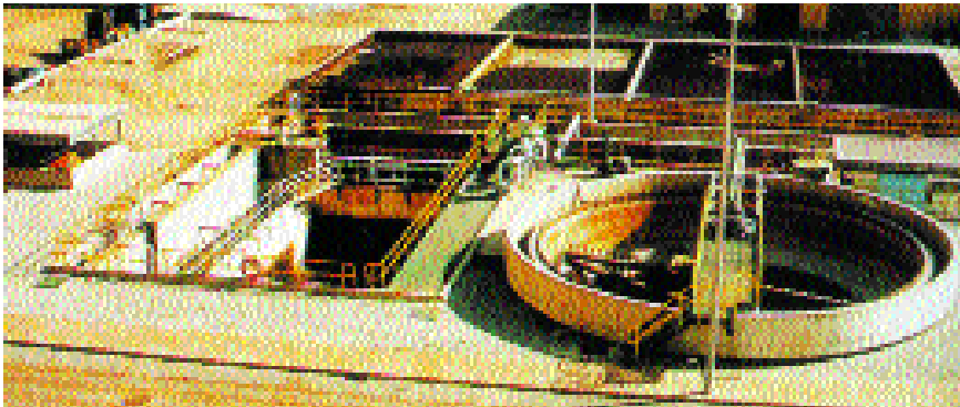
Instalaciones de tratamiento de residuos de la central termoeléctrica de Foix
