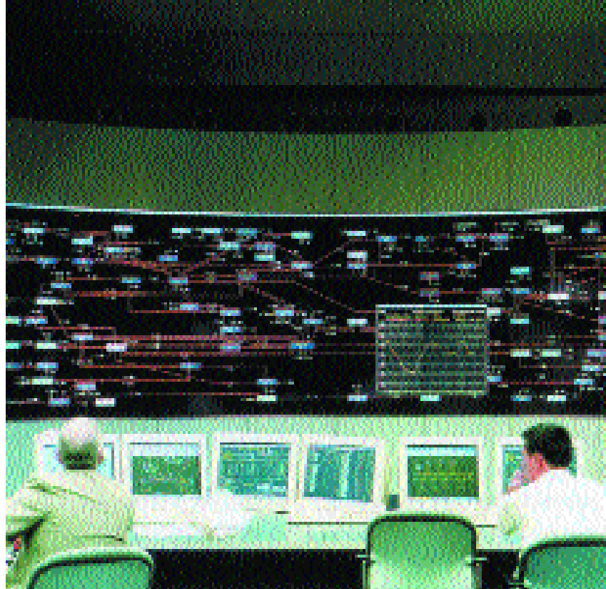
Existe un Centro de Control a nivel nacional para la operación del transporte eléctrico
