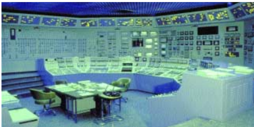
Centro de control de la central nuclear de Ascó
