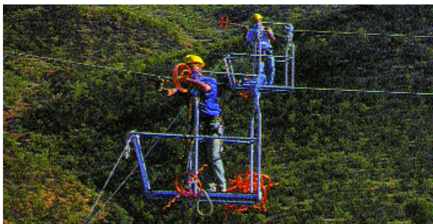
El mantenimiento de las redes exige un gran esfuerzo técnico y humano
