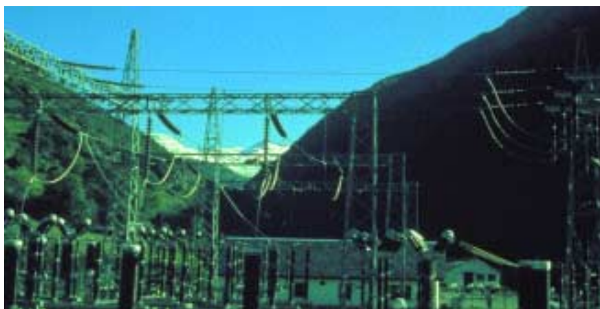
Subestación transformadora de la central hidroeléctrica de Tabescán
