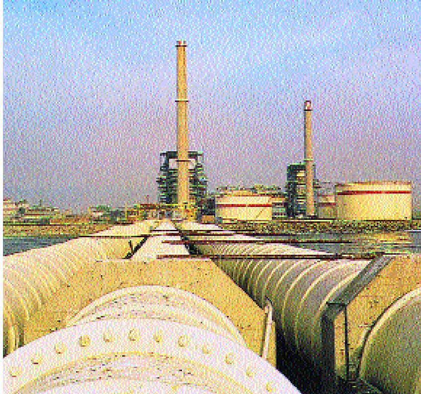
Conducciones de hidrocarburos para una central térmica mixta de fuel y gas
