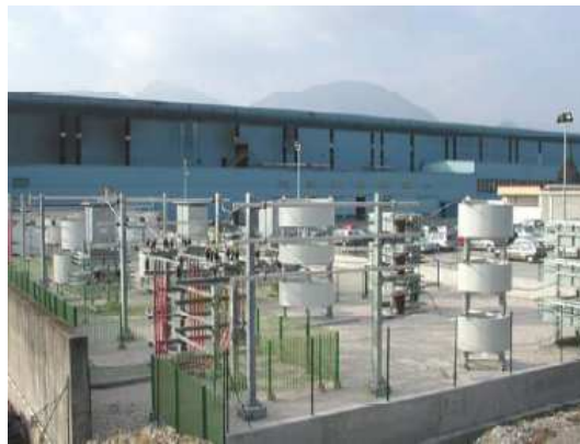
Figura 8.19. Fotografía de la instalación de un SVC
