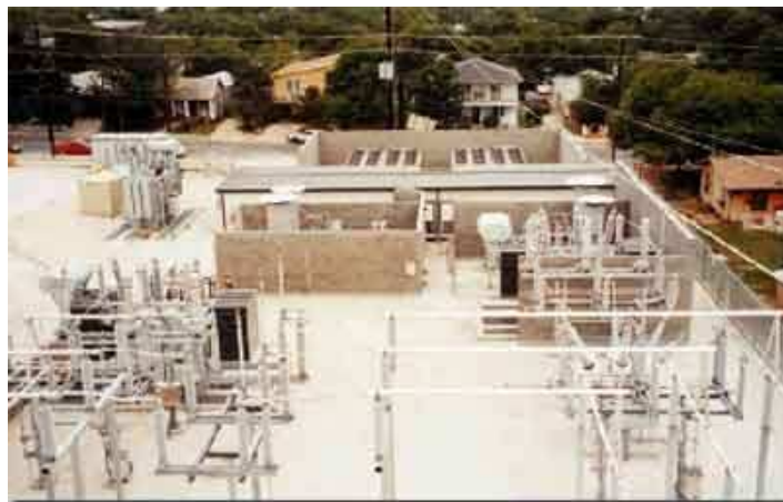
Figura 8.51. Fotografía del enlace de 36 MW, \pm 138\text{kV} HVDC-VSC localizado en la subestación Eagle Pass. Utilizado para exportar/importar energía eléctrica entre AET-TCC en Texas y CFE, México.
