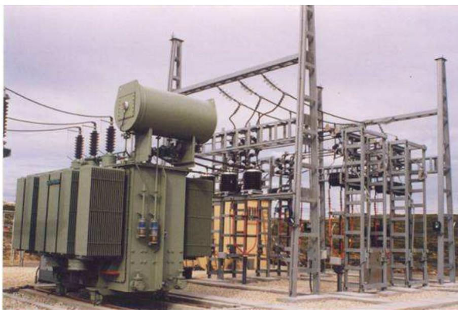
Figura 9.80. Transformador con sus elementos de protección y control
